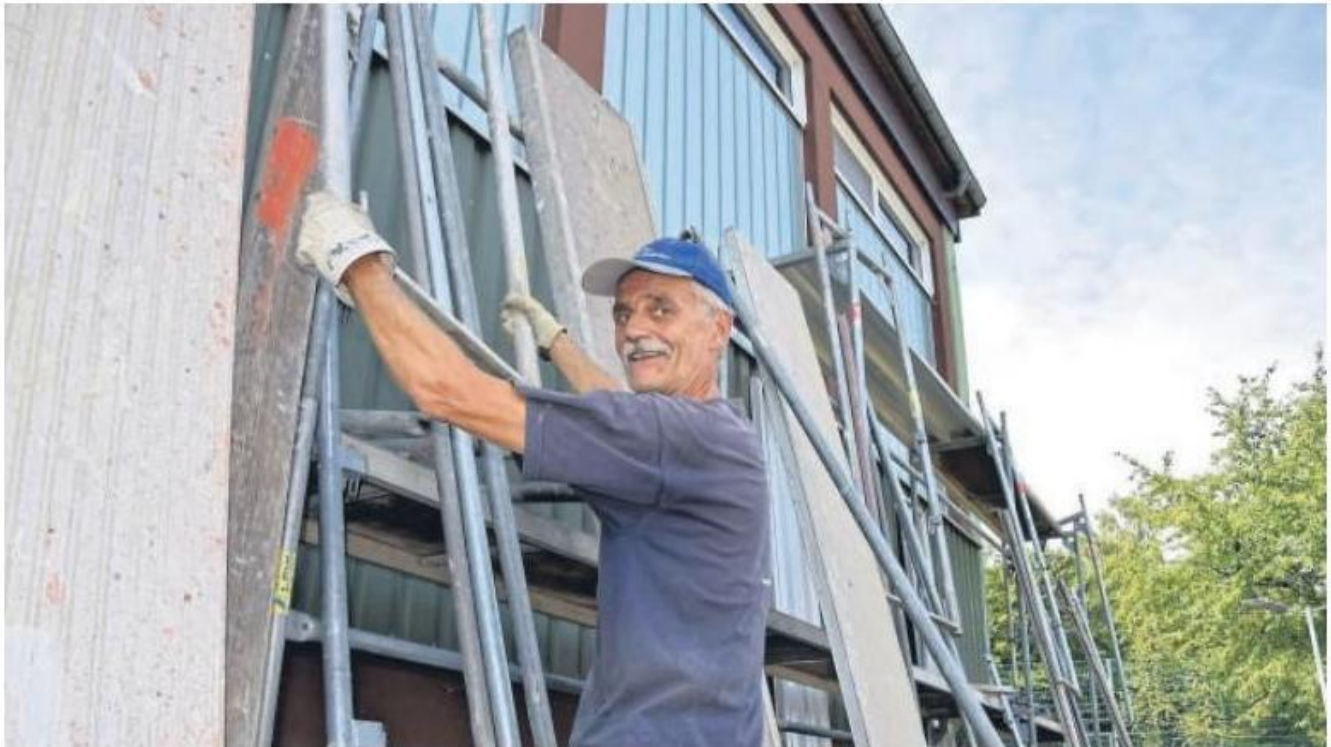
Die kleine Sporthalle der Erich-Kästner-Schule wird seit Monaten renoviert: Wilfried Orth vom gleichnamigen Unternehmen aus Fritzlar-Züschen baut gerade das Gerüst für die Außenarbeiten auf.
