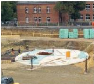
In dieser Zisterne wird das Wasser für die Sprinkleranlagen gespeichert, falls es einmal brennen sollte.
